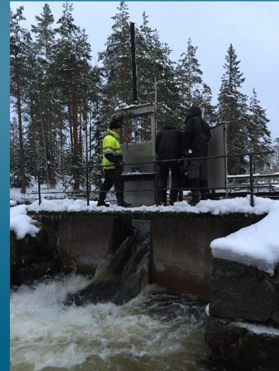
Utskovsluckan vid kanalintaget helt öppen
