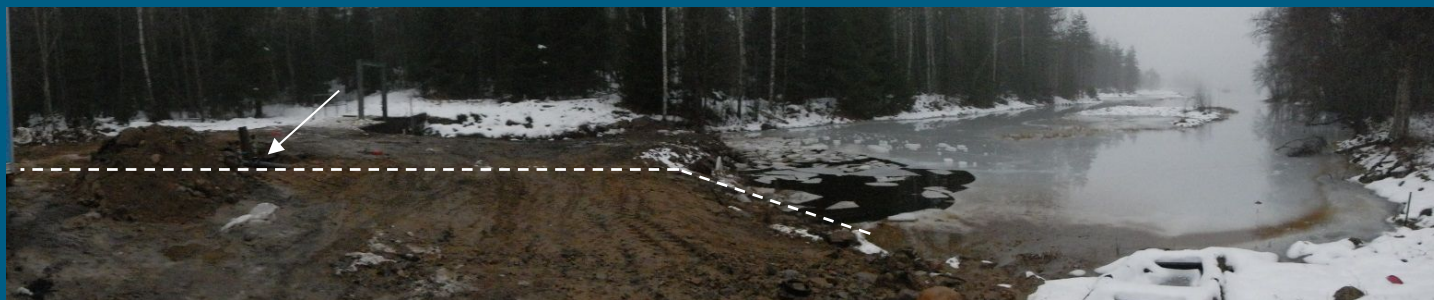
Temporär hävert på plats, förlagd i dammkrönet (nedgrävd 0,5 m)
