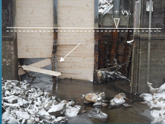
Mittgåtar krokiga i botten. Rosten på mittgåten är borta (stålrent)
