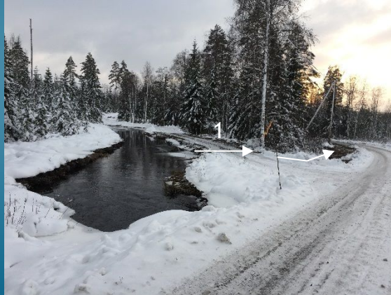
Dammkrön nedströms vägtrumma överdämades (1). Vattenflödet rann ned i vägdiket
