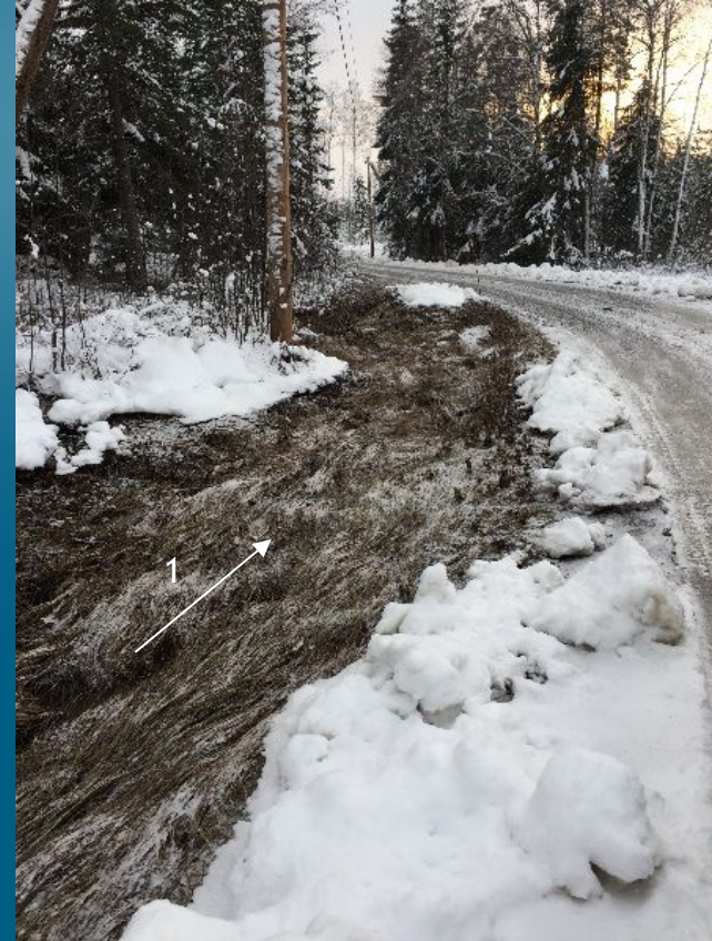
Flöde i dike längs grusvägen ner mot samhället
