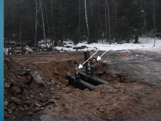
Avstängningsventiler för den temporära häverten
